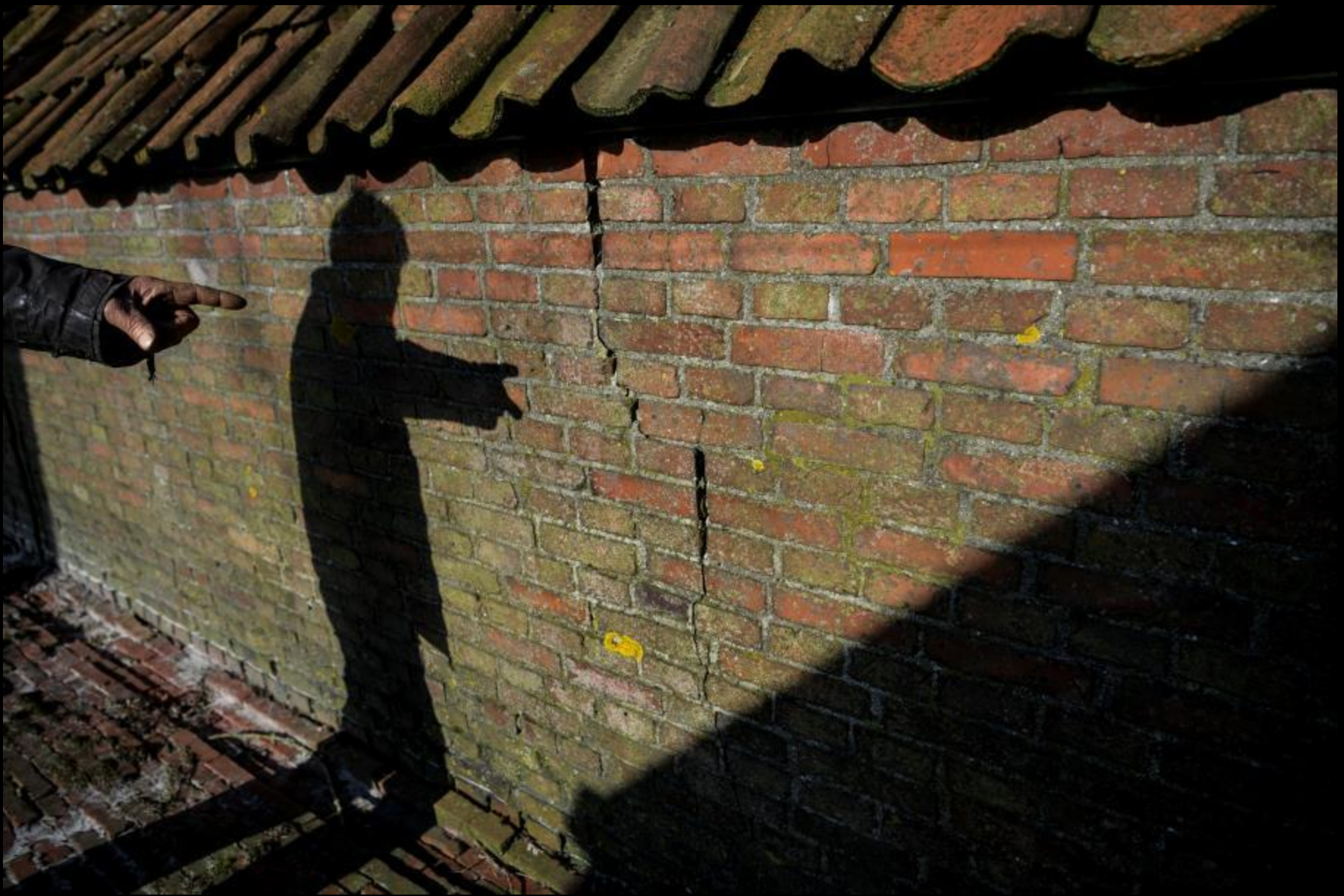
Oude boerderij is zwaar beschadigd door aardbevingen in Noord-Groningen 07-02-2018 Westeremden Fotograaf: Kees van de Veen
